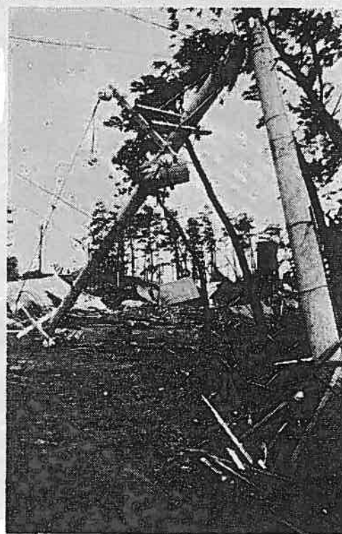
まつぶたつに折れたコンクリートポール 〓 田中町 〓
